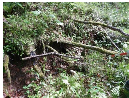
図 5.1.4.6 地すべり土塊の移動に伴う階段状の地形の形成と樹木の根切れ(2023 年 6 月撮影)
