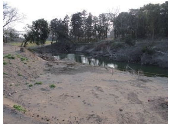
図 16 若宮戸南部溢水発生箇所における地盤洗掘 （2016 年 3 月 4 日撮影）
